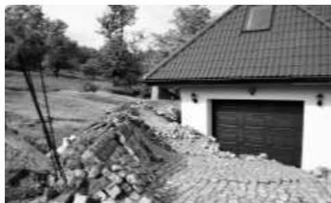
Fot. 1. Zniszczony dom dnia 20.05.2010 roku, rycinie nr 3 oznaczony literą B
