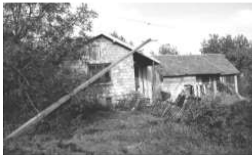
Fot. 5 Nie uszkodzony budynek przy granicy z osuwiskiem, na rycinie nr 3 oznaczony literą E
