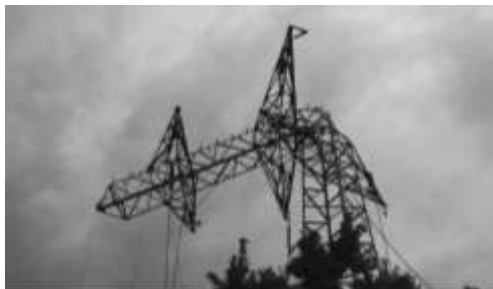
Fot. 7. Zniszczony słup wysokiego napięcia
