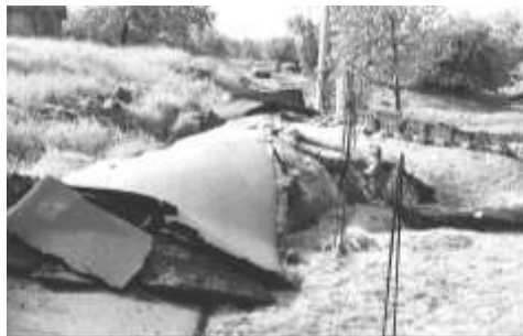
Fot. 6. Zniszczona droga
