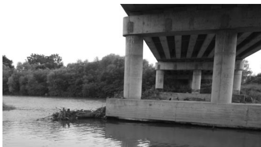
Fot. 4. Podmyte filary mostu drogowego w Witanowicach (źródło: materiały własne).
